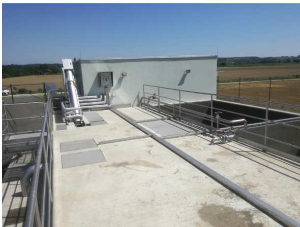
Foto 2- čistilna naprava Filovci-detajl
